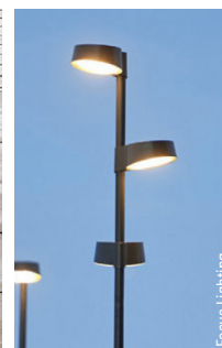
Mastbelysning med dobbeltrettet belysning oplyser de primære og sekundære trafikveje
